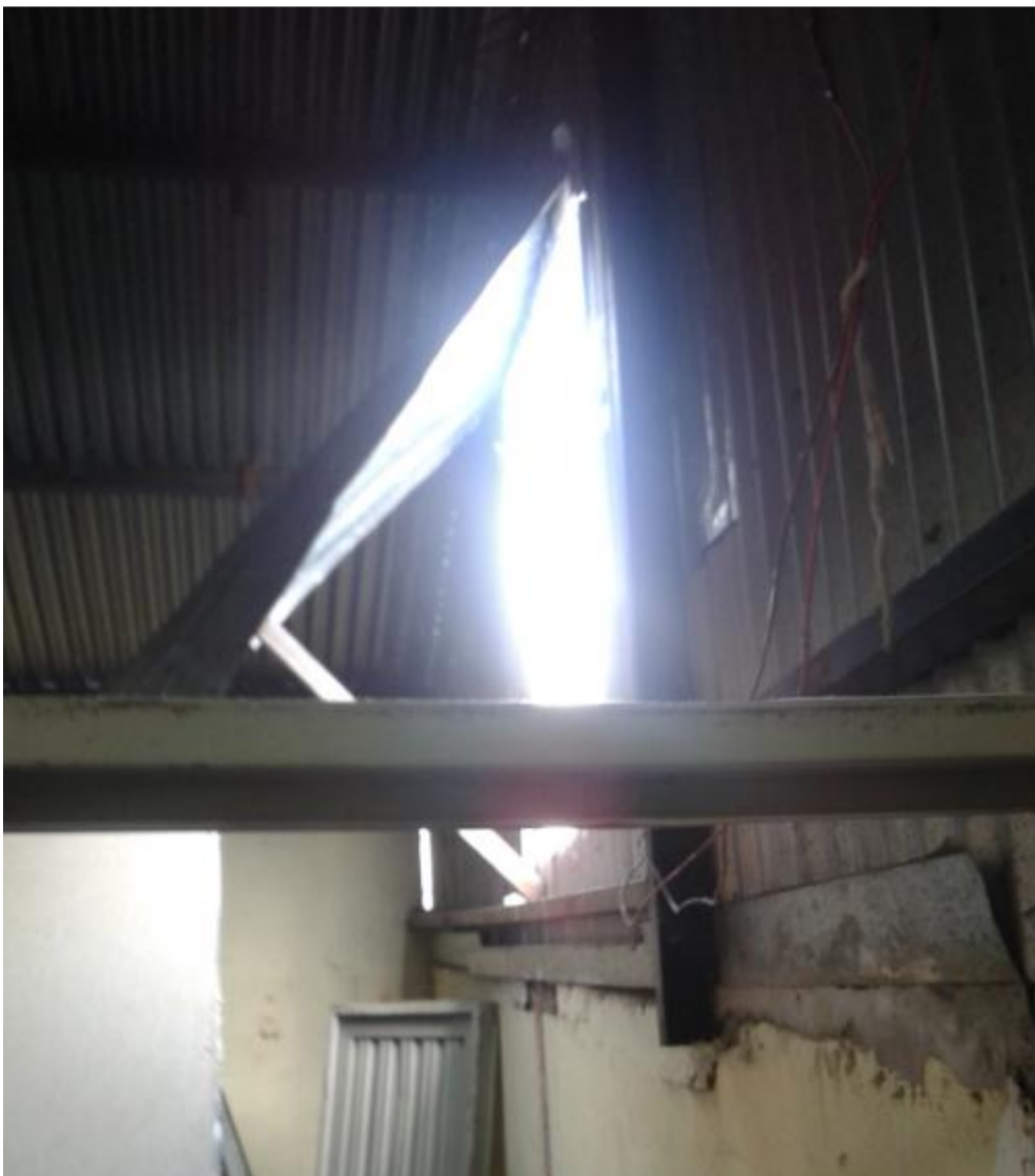
Foto tomada desde el interior de las habitaciones descubiertas, donde se observa la chapa del techo doblada para lograr entrar a éstas.
