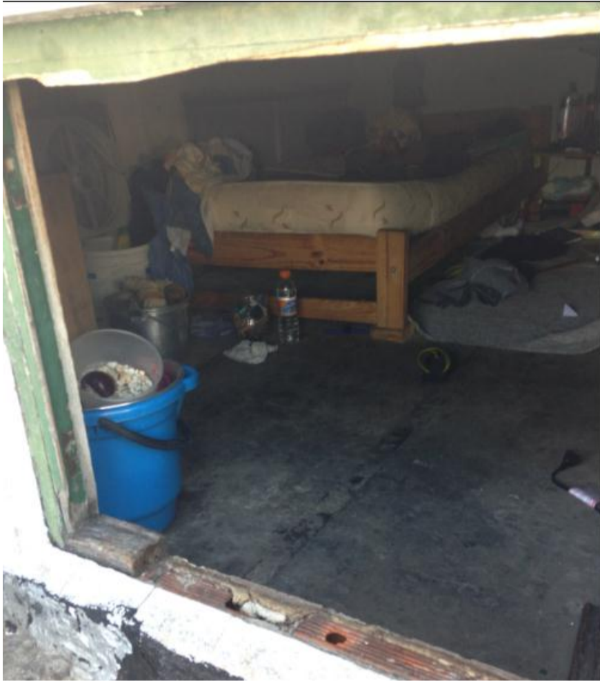
Fotografía de la pequeña ventana de unos 60 centímetros de alto por medio de la cual se ingresa a una de las reducidas habitaciones.
